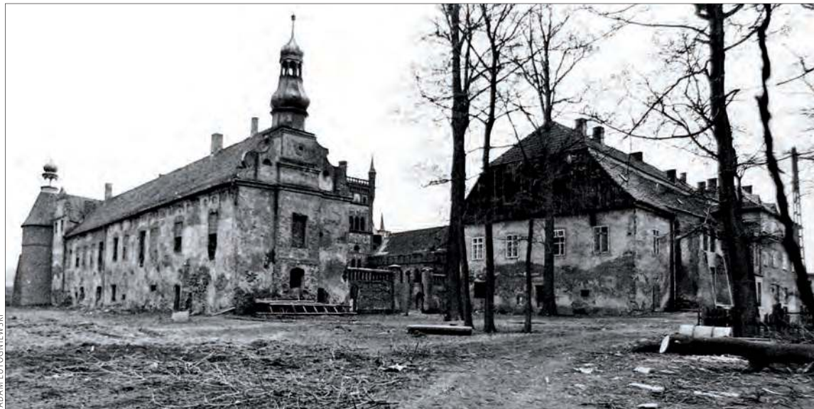
Zamek w Łące Prudnickiej w 1982 roku przed rozpoczęciem remontu
