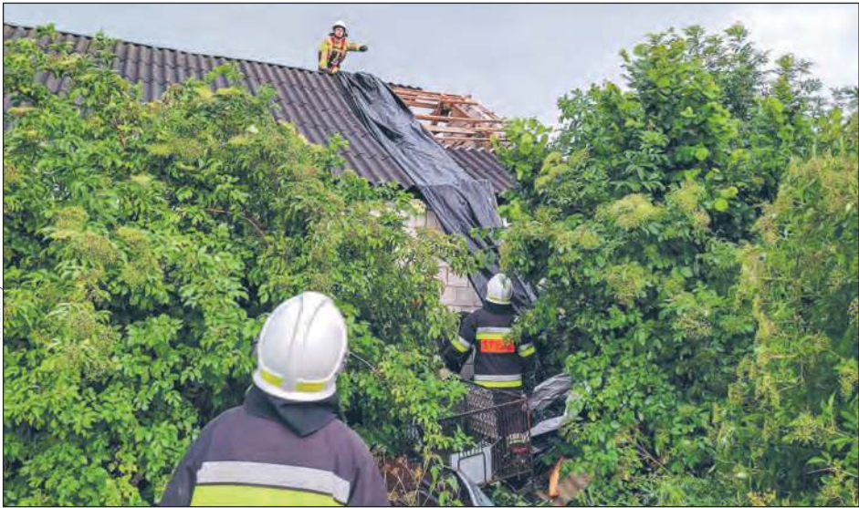
✚ W Zwoli wiatr zerwał dach na budynku gospodarczym. Strażacy zabezpieczyli poszycie dachowe. Następnie zostali zadysponowani do powalonych drzew. Do bazy wrócili po godzinie 22
