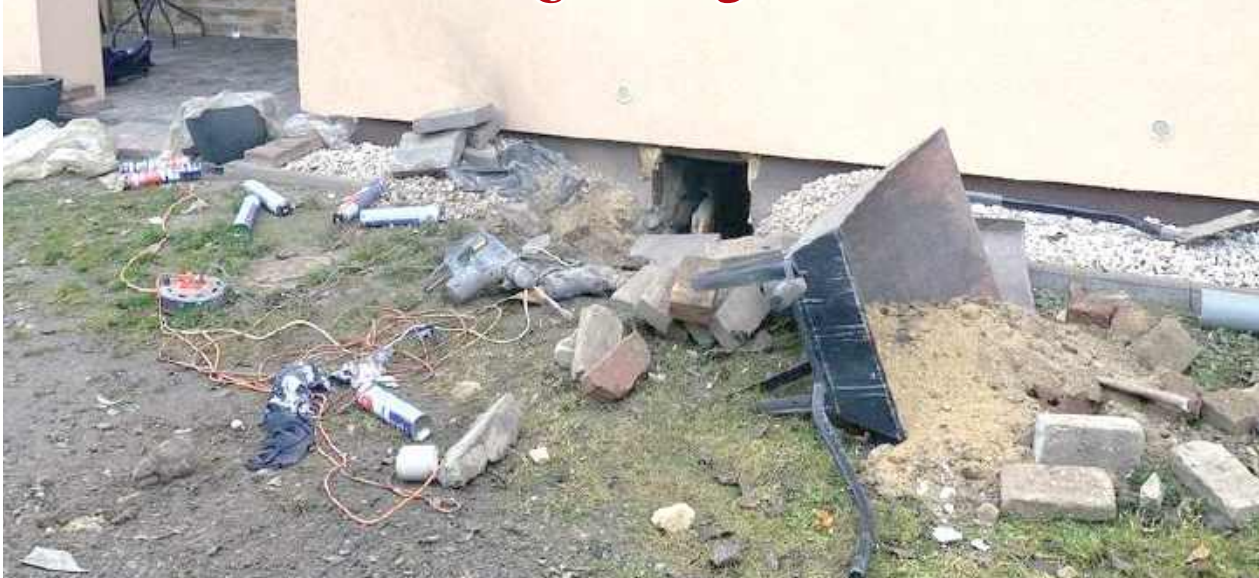
Ślady eksplozji było widać również na zewnątrz budynku
