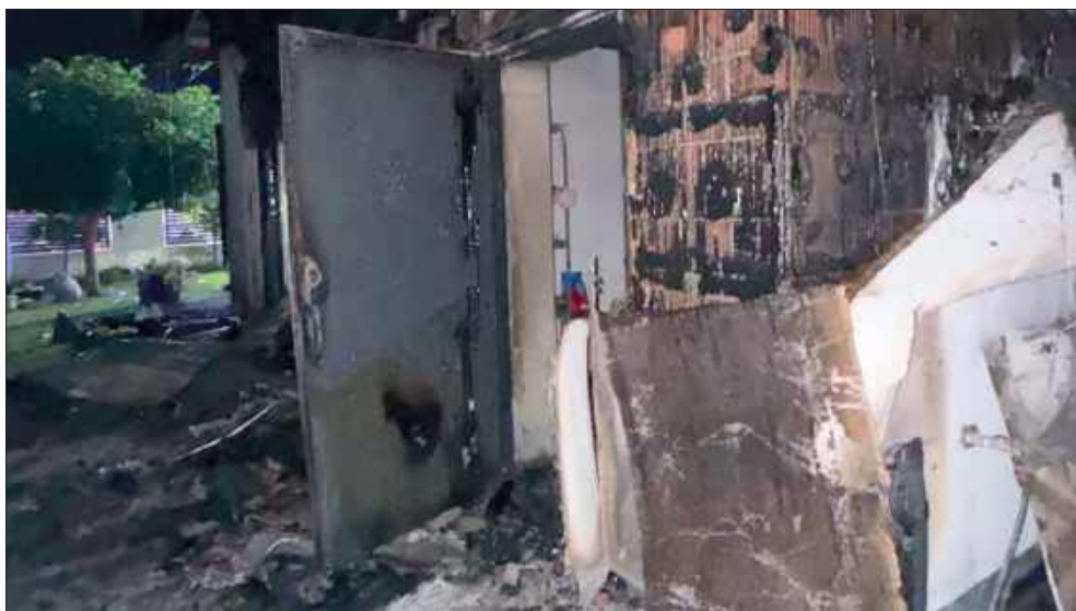
Skala zniszczeń, które spowodował ogień jest ogromna.
