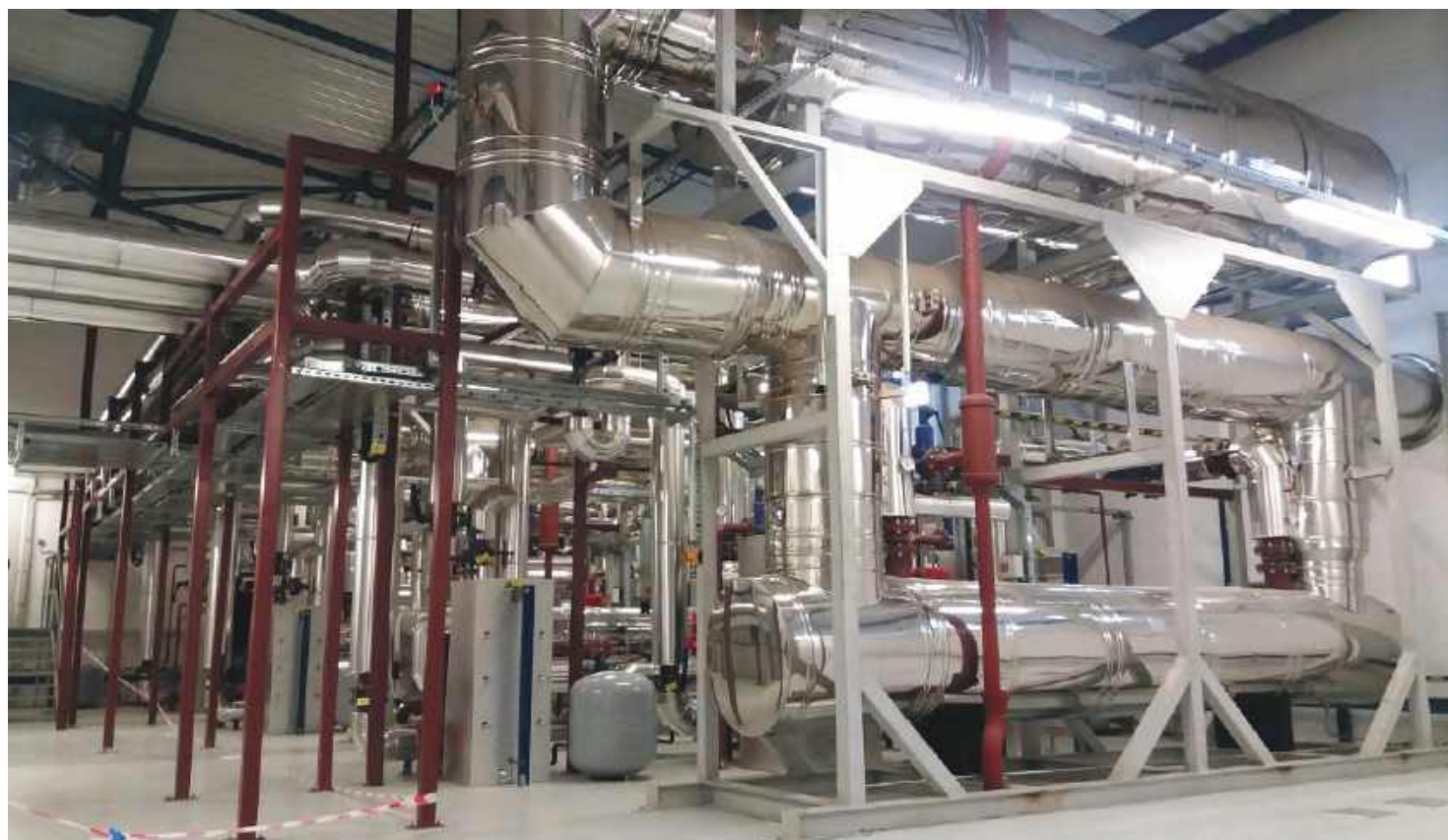
Odzysk ciepła z kogeneracji
