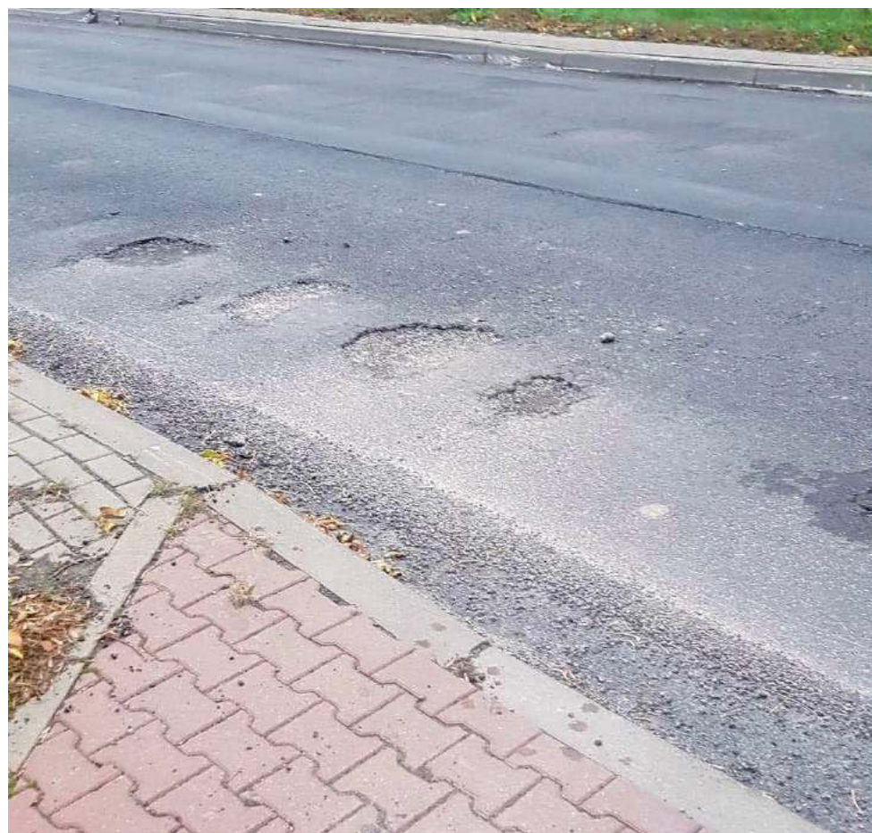
A tak wygląda „nowy” asfalt na Kościuszki
