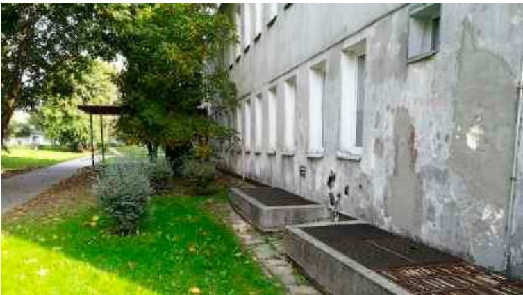
Szara i zrujnowana elewacja Przedszkola nr 2 przy ul. Lawinowej robi przygnębiające wrażenie
