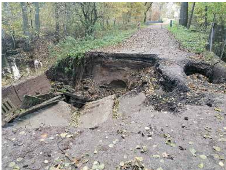
Mostek w Boguszcach zapadł się w październiku 2020 roku. Stało się to chwilę po tym, jak przejechał po nim ciężki sprzęt
