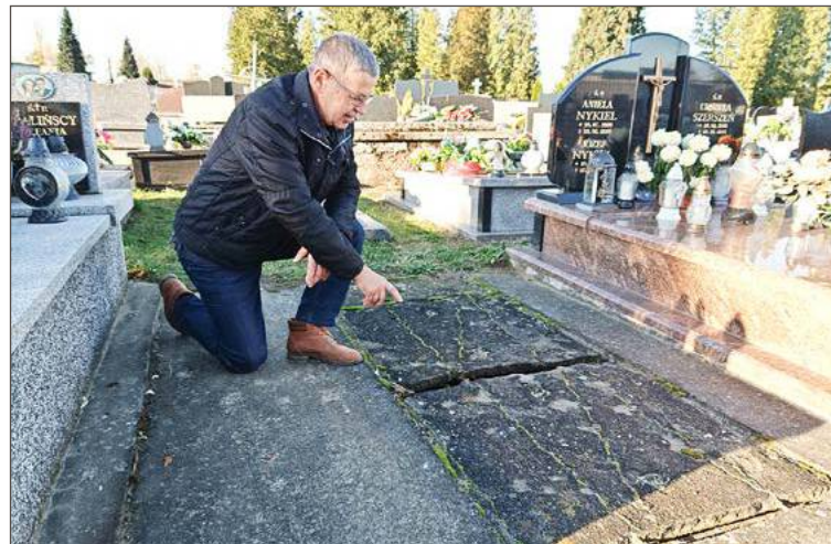
Płyty zabezpieczające piwniczkę lata świetności mają za sobą.
