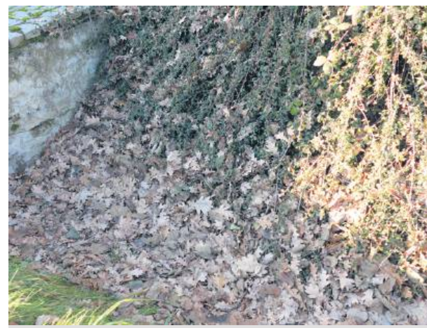
Liście, które zalegają w przydrożnym rowie i to mimo że zdjęcie zostało wykonane zimą kilka tygodni temu. Przepływ jest całkowicie zatkany
