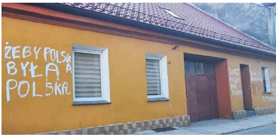
Napisy białą farbą mundurowi znaleźli m.in. na elewacji budynku przy ul. Strzelińskiej, około 50 metrów od rynku. Foto: KPP w Strzelinie
