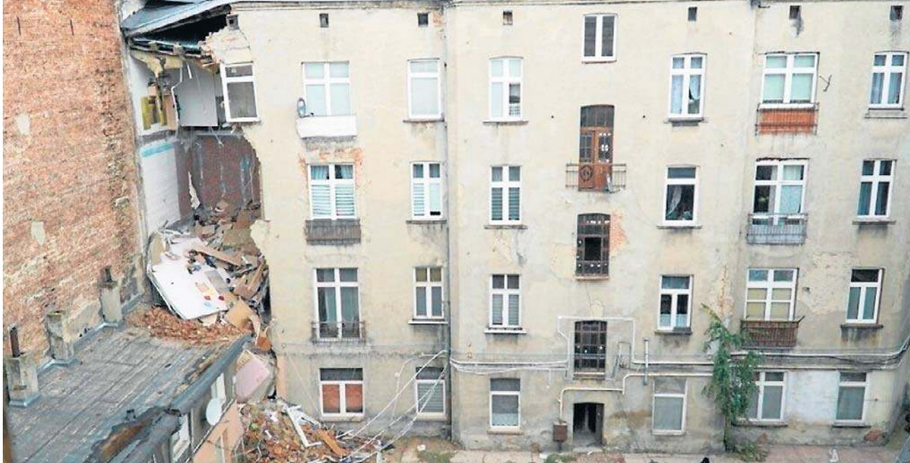
Najpierw poleciała podłoga, potem waliły się kolejne piętra w jednym z pionów kamienicy przy al. 1 Maja 23, pod którą tunel drążyła tarcza Katarzyna
