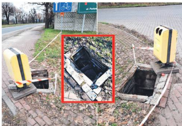
Zdaniem pani Małgorzaty miejsce powinno zostać po prostu naprawione, bo takie zabezpieczenie nie wystarczy
