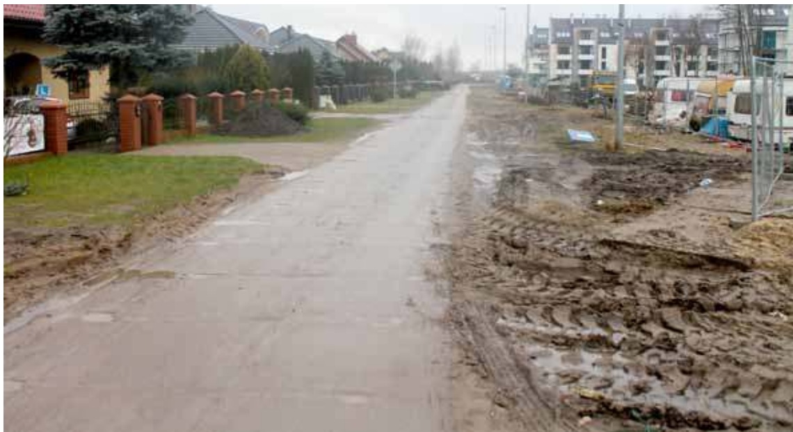
Deweloper zobowiązał się do naprawienia uszkodzeń drogi w okresie wiosennym, kiedy pozwoli na to pogoda
