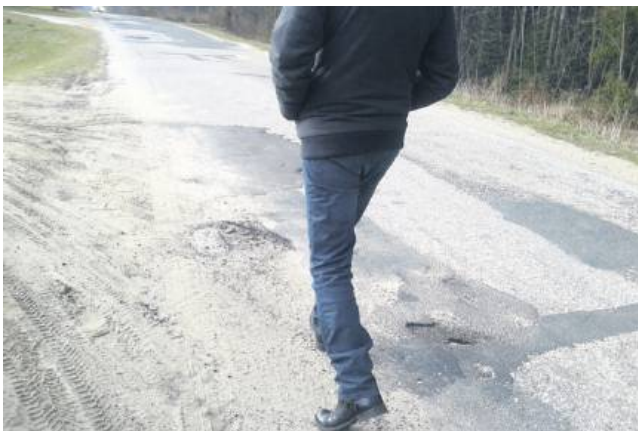
Mieszkańcy podkreślają, że zły stan nawierzchni stwarza niebezpieczeństwo.
