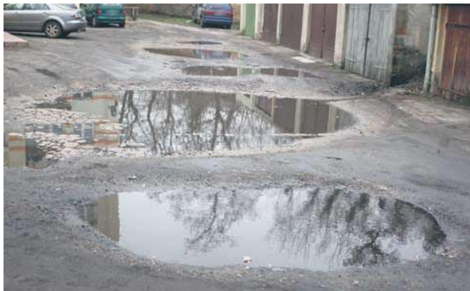
Ostatni odcinek drogi za blokami to już pełna zagłębień gruntówka
