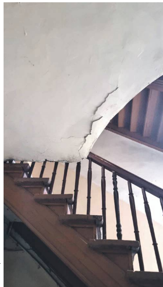
Tak wygląda większość ścian w tej kamienicy
