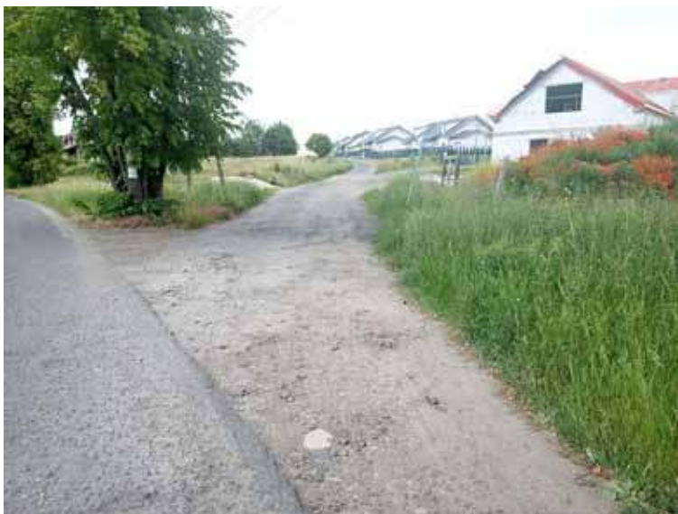
Po opadach deszczu powstaje w tym miejscu sporo błota, co utrudnia znacznie poruszanie się.jpg
