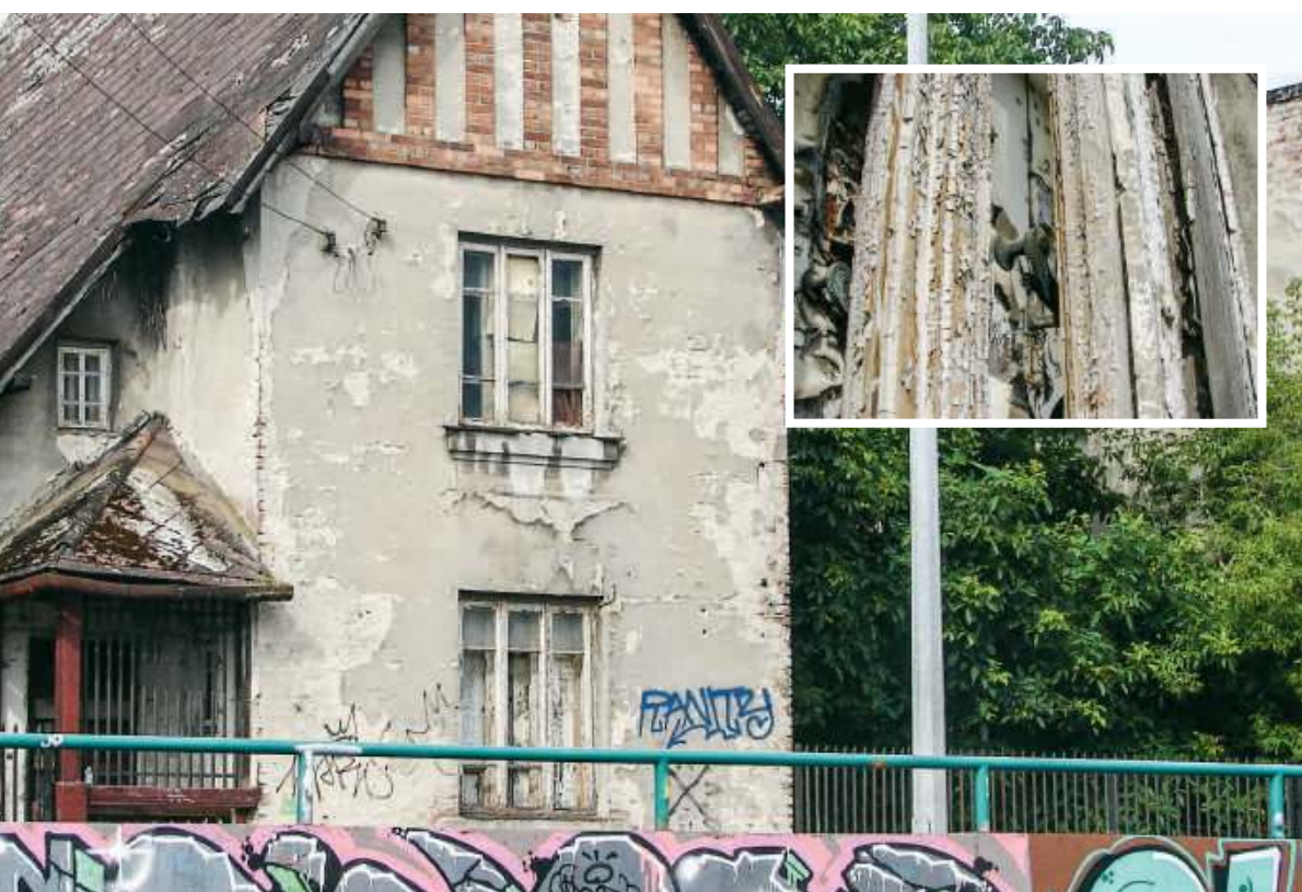
Dom przy ul. Globusowej 9 i fragment zniszczonej stolarki okiennej budynku | fot. Janusz Sujecki/Gazeta Polska
