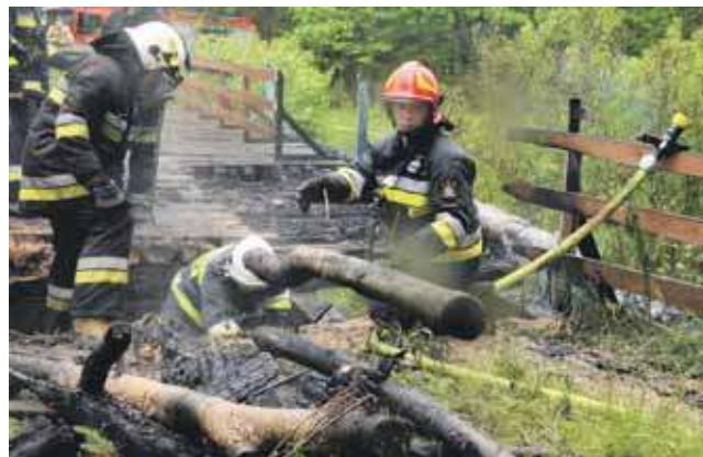
Strażacy rozbiierają tłocząc poszycie mostu w Truszczy. Do pożaru doszło 16 czerwca
