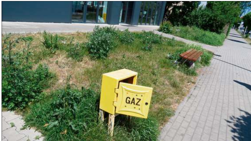
Otwarta skrzynka gazowa, śmieci, chaszcze...to tzw. teren zielony przed pasażem handlowy w centrum miasta.
