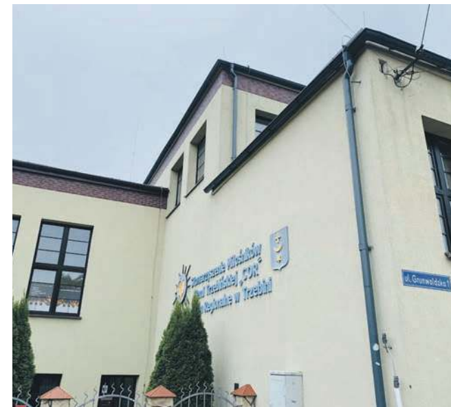
Budynek muzeum przy ul. Grunwaldzkiej 1 wymaga nie tylko remontu dachu. Do naprawy są też m.in. schody
