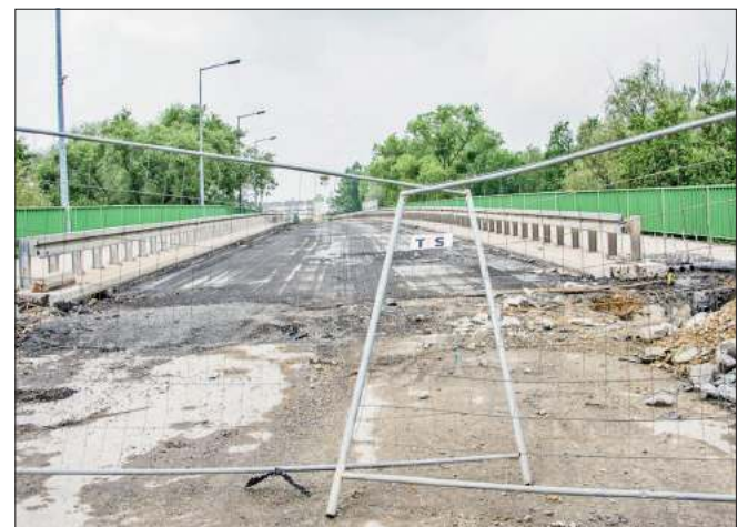
Półroczne opóźnienia, jakie wystąpiły na remontowanym wiadukcie wzdłuż ul. Jastrzębskiej, spowodowane są próbą kradzieży stali
