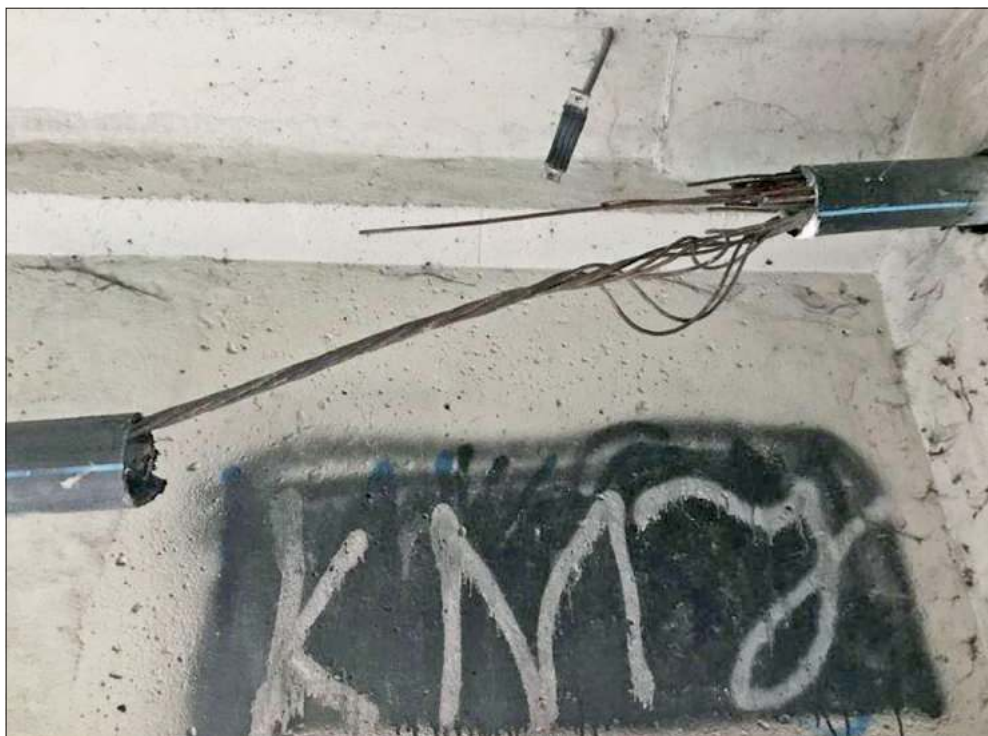
Uszkodzony kabel sprężającym
