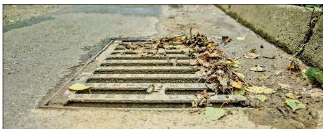
Zapychane liśćmi studzienki kanalizacyjne, to kolejny problem, z którym zmagają się mieszkańcy ul. Dębowej
