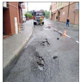
Spywająca woda uszkodziła nawierzchnię przy ul. Wałowej w Wodzisławiu Śląskim
