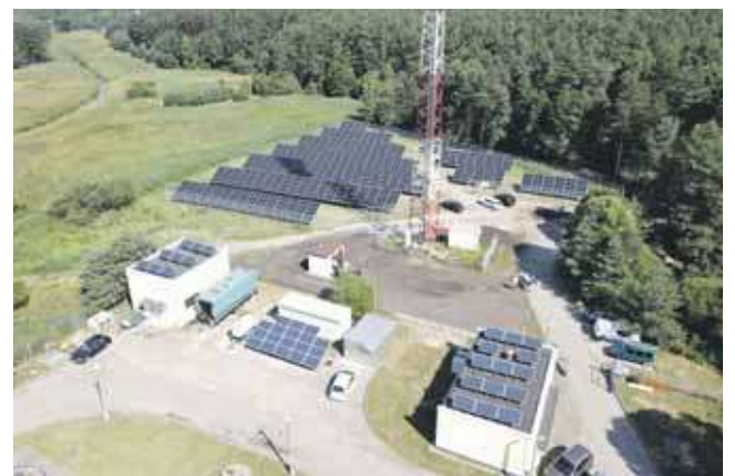
Na budynkach oczyszczalni ścieków zamontowano kiedyś instalację o mocy 10 kW, która znacząco ograniczała wysokość rachunków
