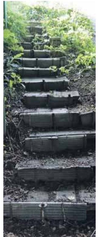
Radny zwracał uwagę, że schody na skarpie od strony ROD są w fatalnym stanie. Okazało się, że nie wykonała ich GDDKiA
