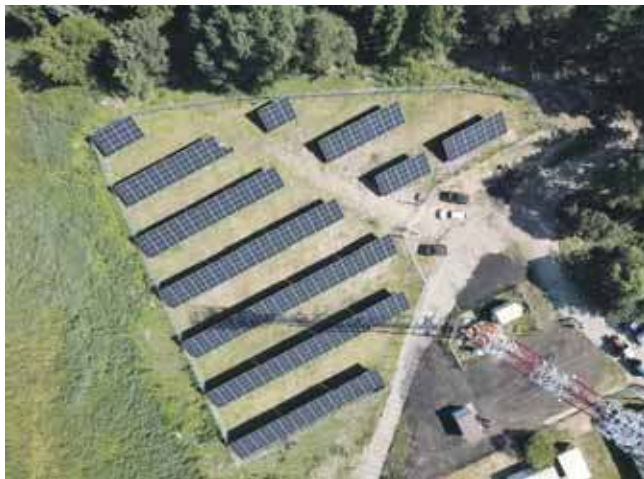
Moc szczytowa nowej instalacji fotowoltaicznej sięga 200 kW
