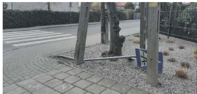
Podczas zdarzenia uszkodzona została również infrastruktura drogową
