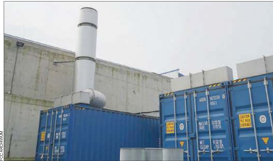
Stacja oczyszczania powietrza z filtrami w zabrzańskim zakładzie FCC.
