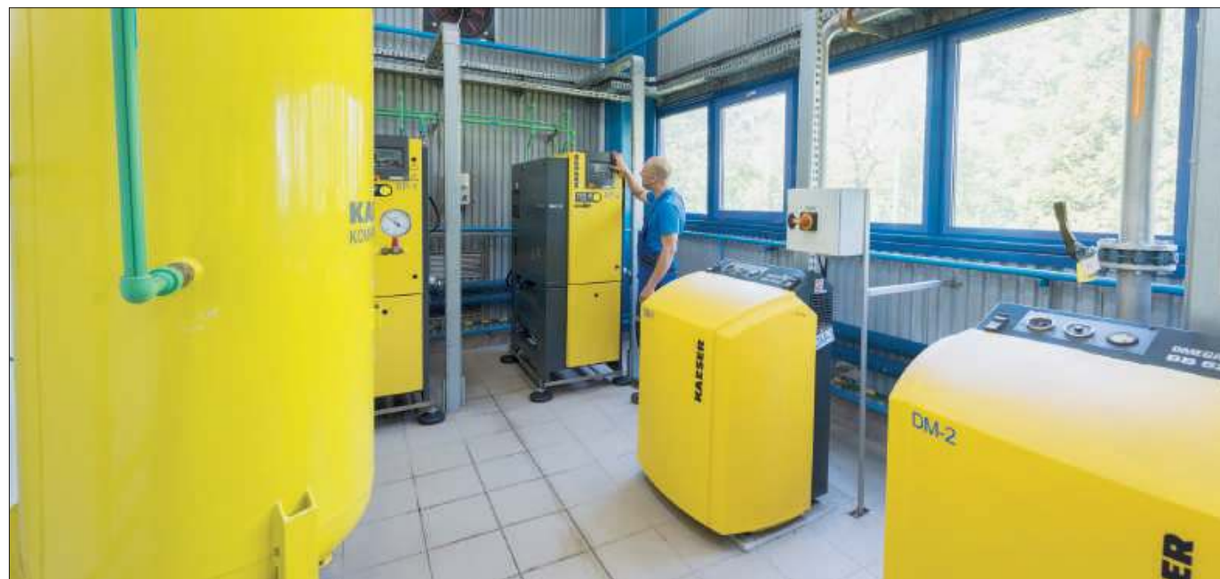
Stacja uzdatniania wody w Zabrzu Mikulczycach.
