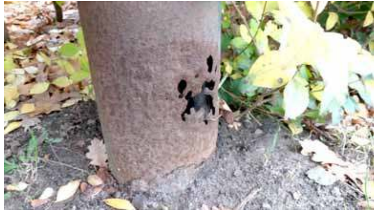
Mieszkańcy z niepokojem patrzą na tak dalece zniszczone rdzą słupy
