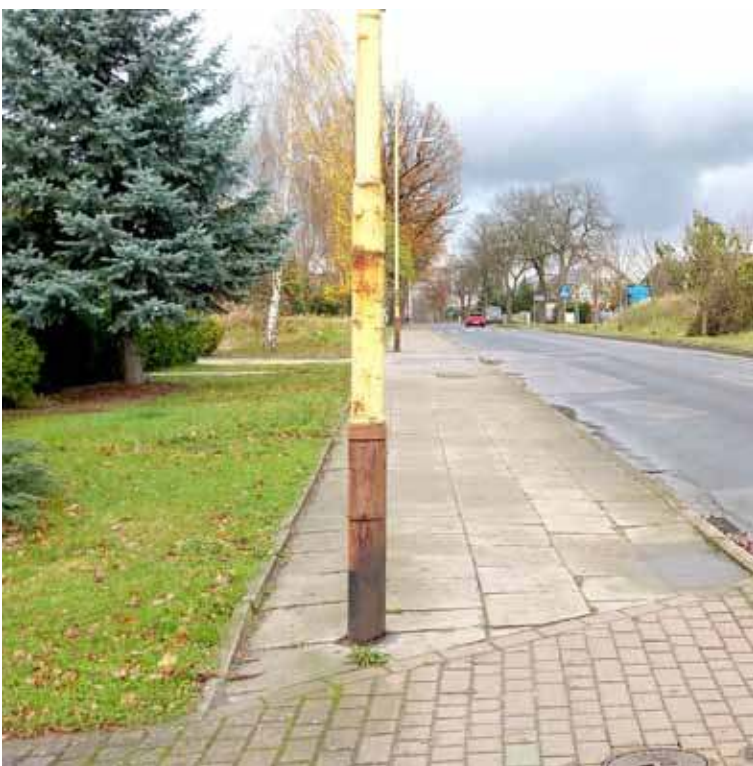
Oprócz wątpliwej przy tym zaawansowaniu korozji wytrzymałości słupa, taki wygląd zakłóca estetykę miejsca
