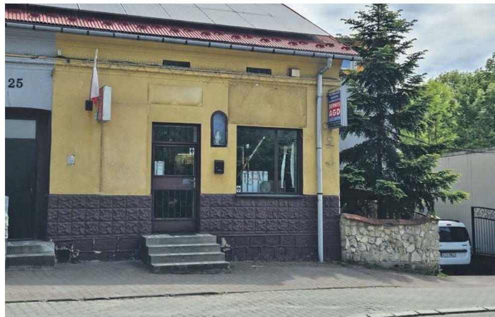
Ślady na budynku po ściągniętych szyldach w centrum Chrzanowa
