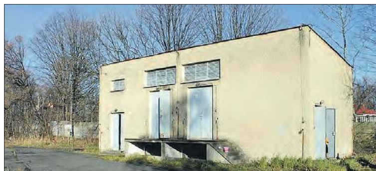
Złodzieje okradli wyposażenie stacji transformatorowej
