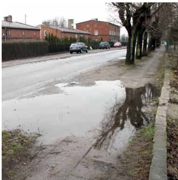
Na zdjęciu widzimy zły stan chodnika przy ul. Głównej. Nie można tamtędy przejść z powodu ogromnej powstałej po opadach kałuży
