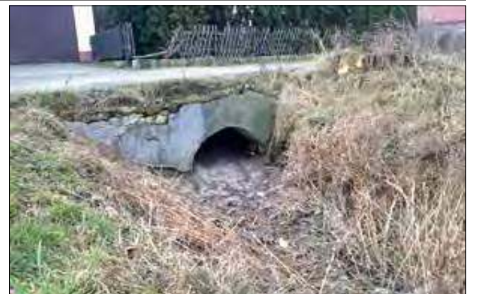
Przejazd przez przepust jest niebezpieczny.
