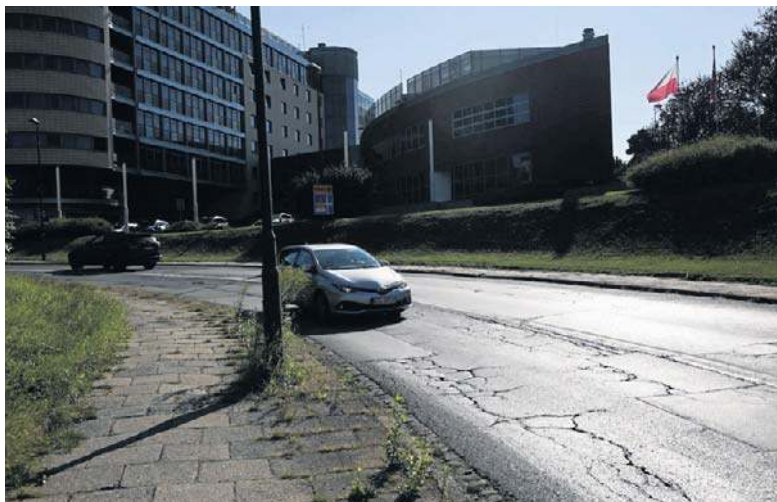
Nawierzchnia ulicy Solnej na Zabłociu jest w fatalnym stanie
