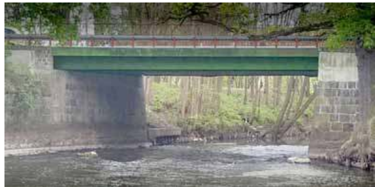
Chodnik znajdujący się na moście przy ulicy Chrobrego jest w fatalnym stanie.
