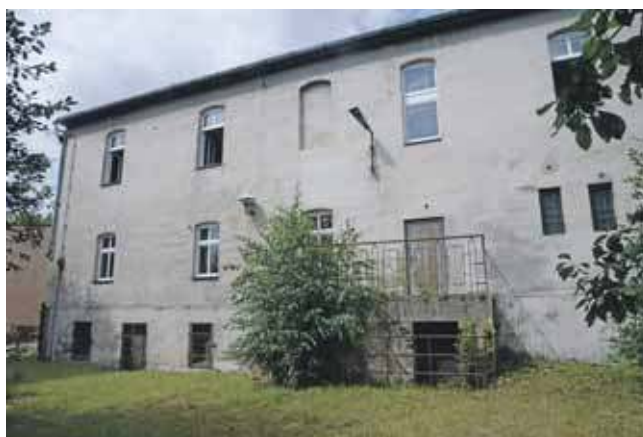
– Mamy oceny stanu technicznego budynku TCK w Reptach Śl. – ostatnia z sierpnia tego roku. Budynek jest w stanie niezadawalającym – informuje rzeczniczka prasowa Urzędu Miejskiego w Tarnowskich Górach
