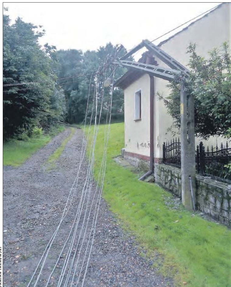
Uszkodzona linia energetyczna
