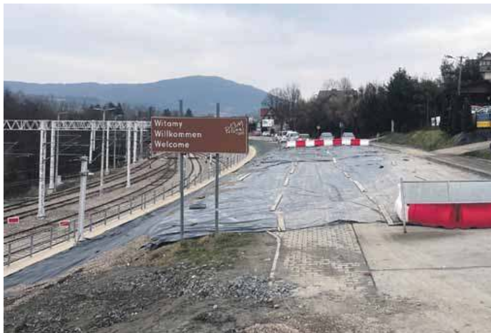
Uszkodzony przez osuwisko odcinek ulicy Zakopiańskiej
