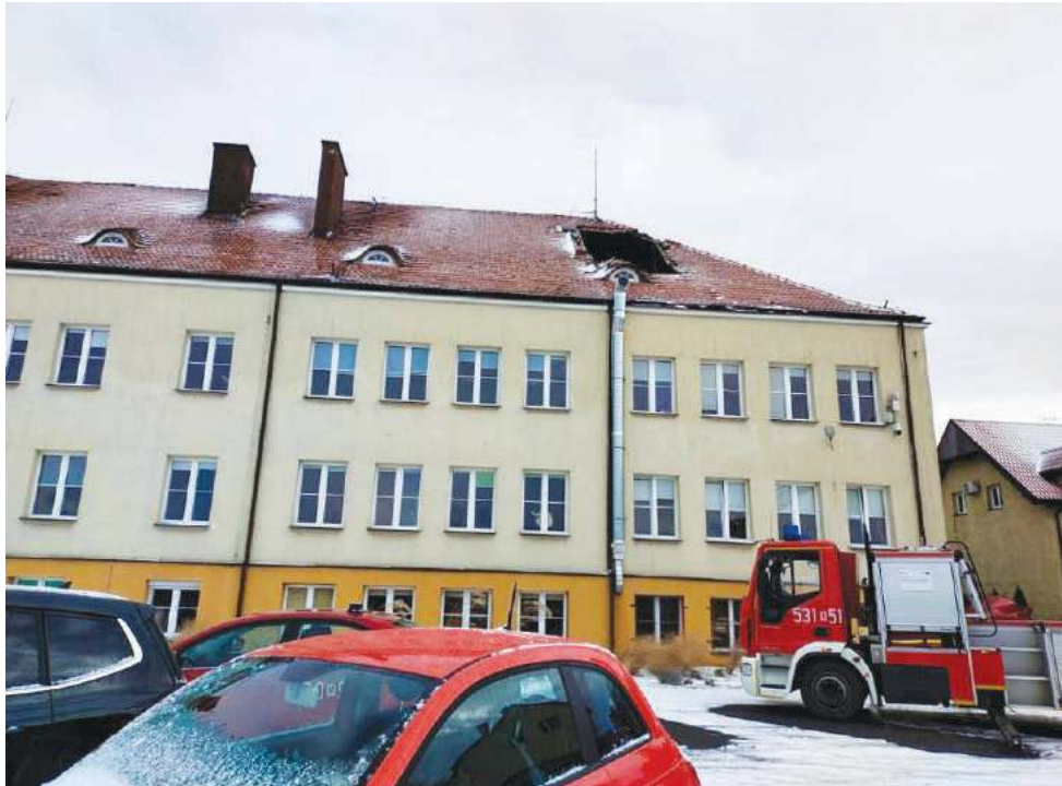
W dachu powstała spora dziura. Na szczęście nikomu nic się nie stało
