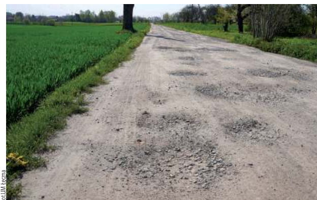
Droga nr 105192L w Trębaczowie przed modernizacją. Jak informuje Urząd Miejski, chodzi o przebudowę odcinka długości 489 metrów. „Podbudowa drogi zostanie wykonana metodą recyklingu węglowego na zimno samobiezną maszyną frezującą i układającą. Na warstwę podbudowy z recyklingu zaprojektowano kruszywo mineralne stabilizowane mechanicznie oraz warstwę wiążącą i ścierną z betonu asfaltowego” Umowa z wykonawcą prac - Przedsiębiorstwem Robót Drogowych Lubartów S.A. - została podpisana 24 kwietnia. 2023 roku została podpisana umowa na realizację inwestycji pn. „Modernizacja drogi nr 105192L w miejscowości Trębaczów”
