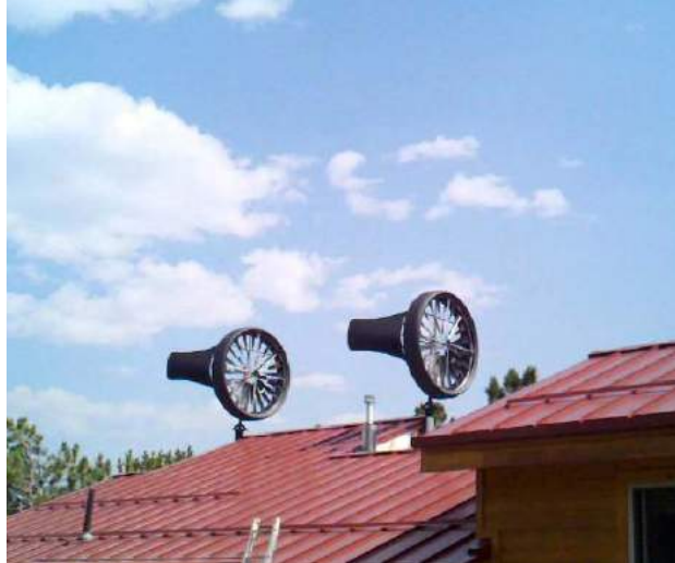
7. Zainstalowane na dachu domu małe turbiny Honeywella
