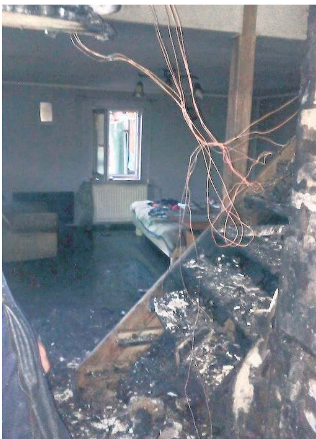
Spaleniu uległy drewniane elementy budynku oraz schody.
