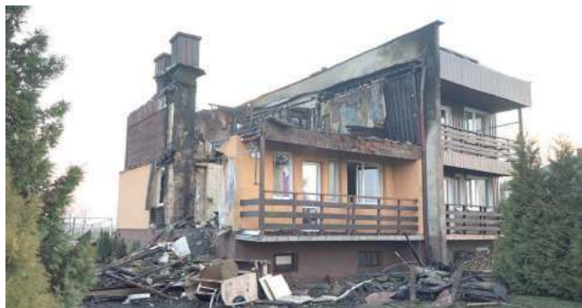
Mieszkania na piętrze i na parterze domu nie nadają się do zamieszkania
