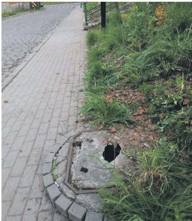
Dziura na ulicy Kolejowej
