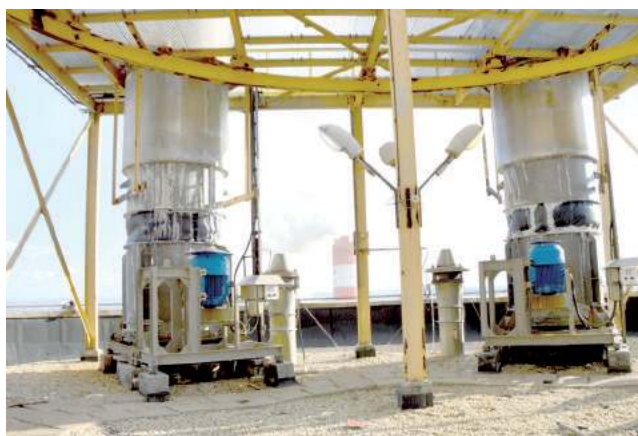
Na szczycie wieży granulacyjnej pracują takie oto urządzenia
