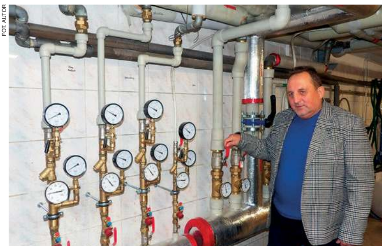
Dyrektor Waldemar Rybak w jednym z pomieszczeń akuratu zmodernizowanej szpitalnej kotłowni
