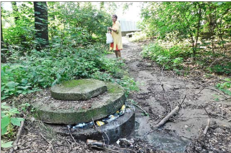
W otwartą studzienkę powpychane były butelki, puszki i inne śmieci.
