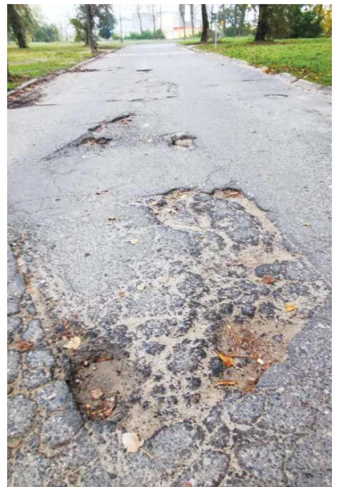
Zniszczona droga dojazdowa do stacji PKP
