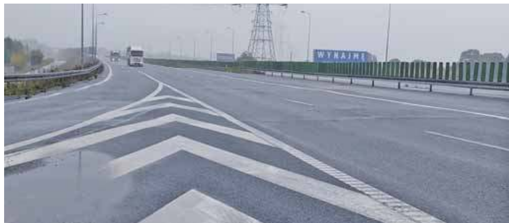
Pofałdowany odcinek autostrady A1
