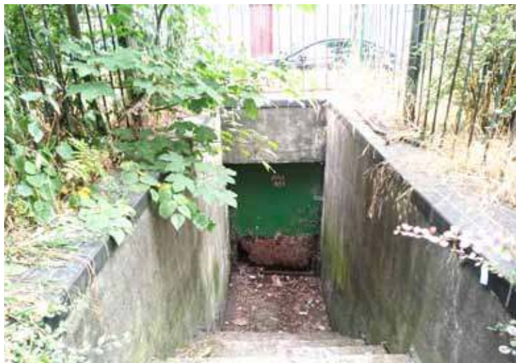
Stan wejścia do schronu pozostawia wiele do życzenia
