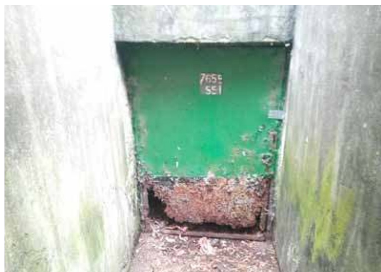
Patrząc z bliska można łatwo dostrzec, że drzwi wejściowe są do połowy zniszczone rdzą
