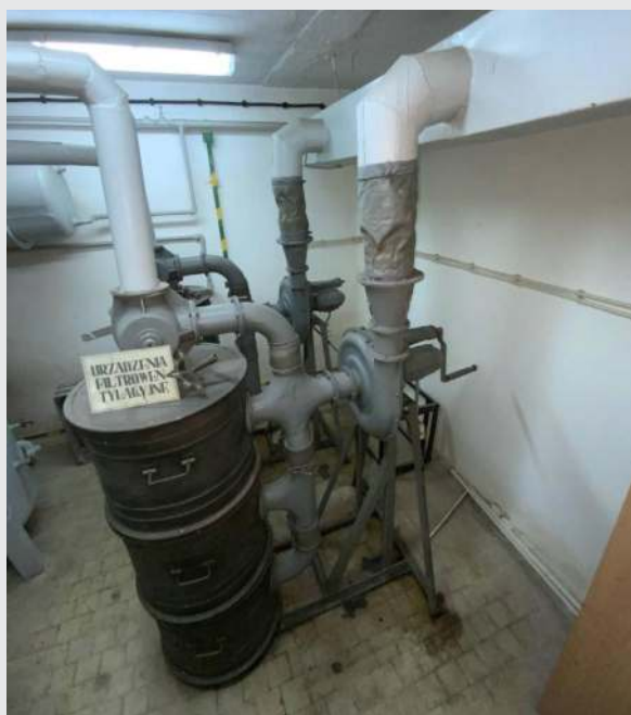
Fot. 2 Pomieszczenie wentylatorni z urządzeniami umożliwiającymi napęd ręczny; lokalizacja urządzeń jest nietrafna – korzystanie z nich w sposób efektywny będzie utrudnione
